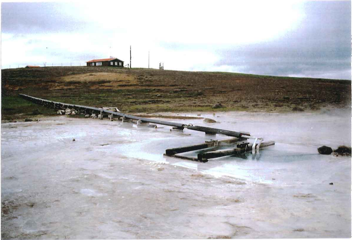
Mynd 14. Ljósmynd af Bóluhver og rörum sem liggja að Veðurathugunarstöð. Rör að kofa Sauðfjárveikivarna liggur til hægri (austurs) frá hvernunum (ljósm. Helgi Torfason, 07. 07 1996).
