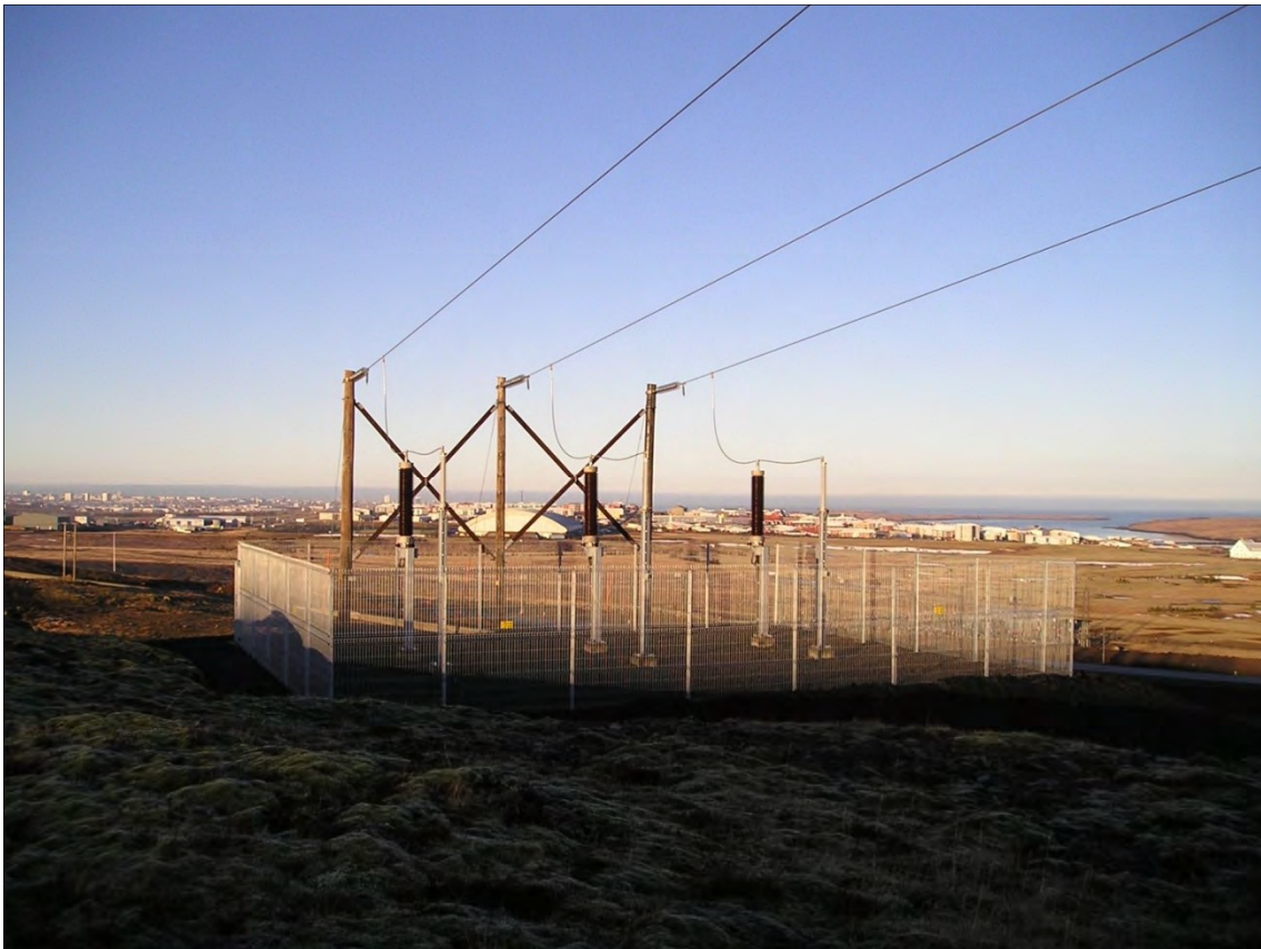
Mynd 3.10 Korpuvína 1, 132 kV – Endavirki með tréstaðu.
