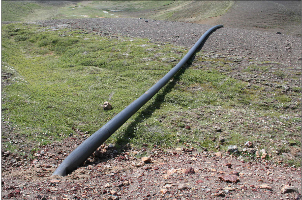
Mynd 4.5 Lögn sem flytur borvatn frá borun (úr svarfþró) og síðar skiljuvatn frá hljóðdeyfi við prófanir. Myndin er tekin af núverandi borteig við Rauðhól þar sem borsvæði H er fyrirhugað.
