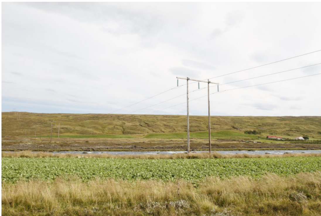
Mynd 4.16 Kröflulínu 1 þverar Bárðardal í landi Hlíðarenda að vestan og Kálfborgarár að austan. Horft til austurs yfir Skjálfandafljót af landi Hlíðarenda. Sjá má hvar raflínan liggur um land Hlíðarenda upp á Fljótsheiði. Gert er ráð fyrir að tengivirkið verði vinstra megin við línuna miðað við þetta sjónarhorn.
