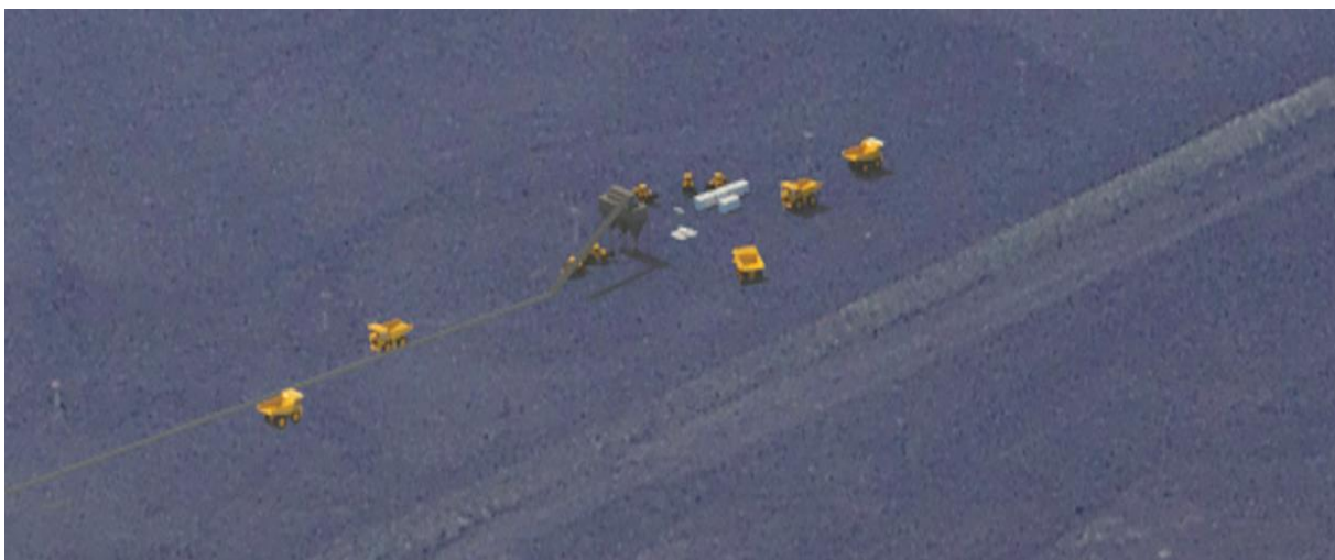
MYND 5.26 Nærmynd af vinnubúðunum. Fjórar gámaeingar fyrir starfsmenn, olútankur, 10 m hleðslustöð, færiband, 5 hjólaskóflur og 5 búkollur af allra stærstu gerð. Á myndinni sést rétt móta í loftlínu Rarik en til stærðarviðmiðunar þá eru 100 m á milli staura.
