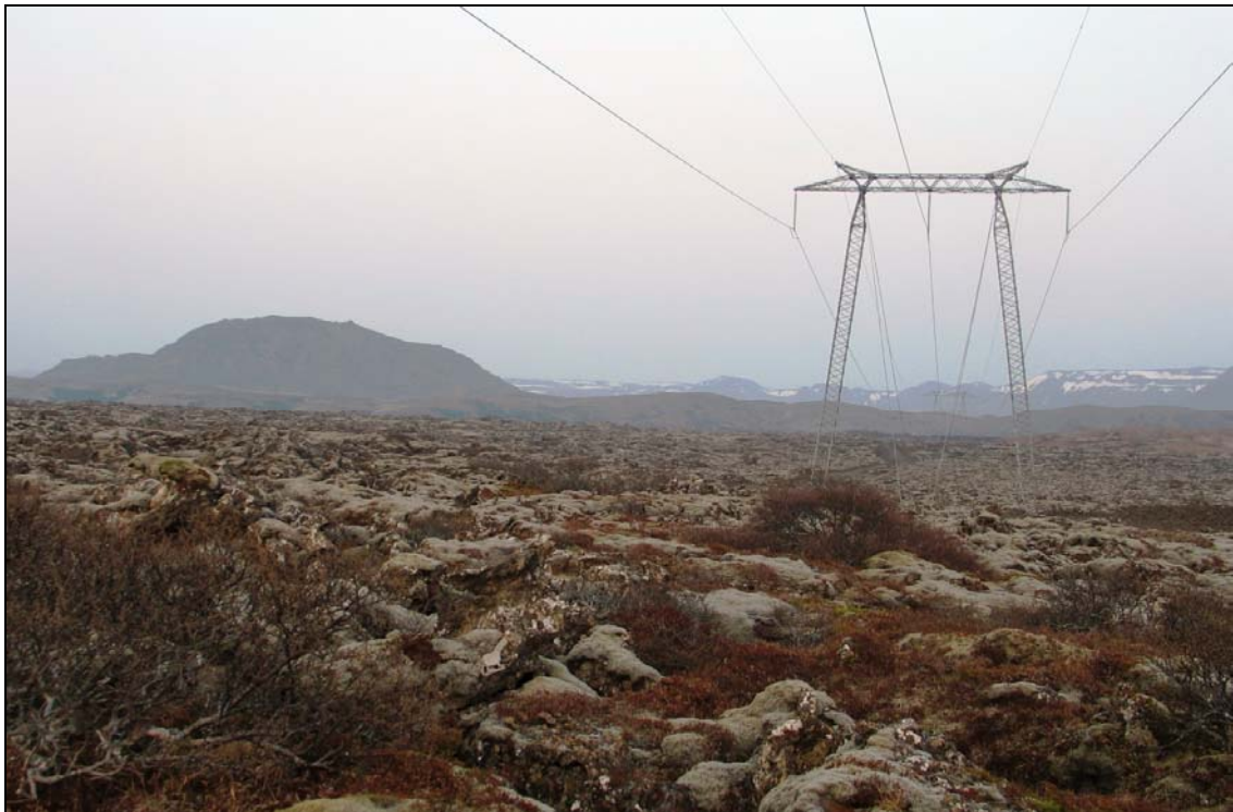
Búrfellslína 3, Helgafell í baksýn.
