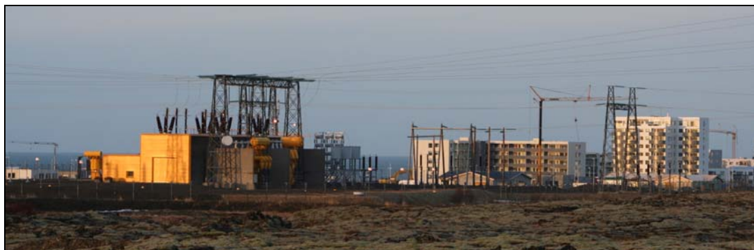
Tengivirkid við Hamranes og Hamraneslínur (til hægri) liggja mjög nærri íbúðabyggð á Völlumum í Hafnarfirði.
